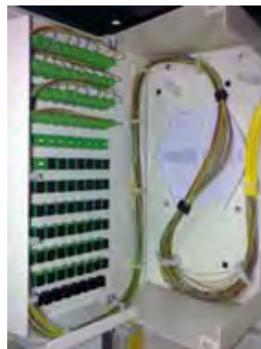
Paneles de distribución y mangueras pre conectorizadas
