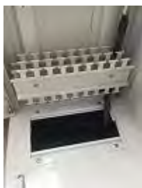
Entradas de cable con cepillo. (Superior e inferior)
